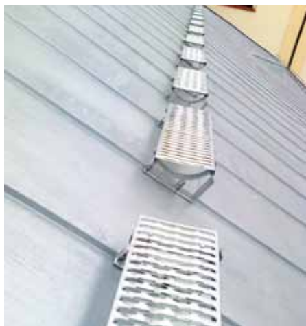
▲ Szereg ław kominiarskich zamontowanych od strony dziedzińca
